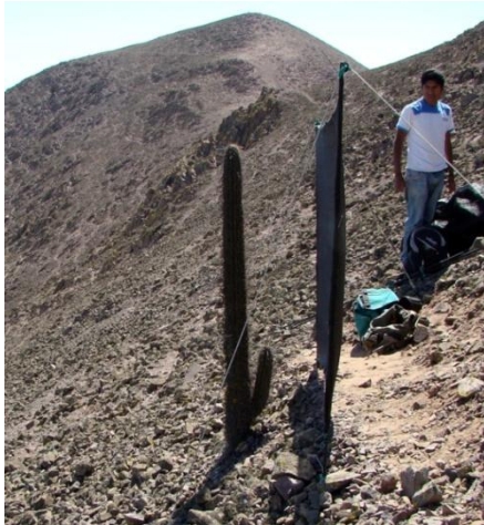
Abril 2011. Instalación de atrapaniebla 1.50 m de alto
